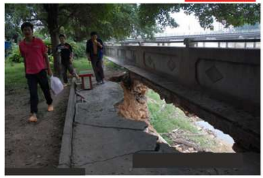
2011年7月5日，广东清远市，笔架河，受持续干旱和水位异常影响，河堤出现坍塌，观光步道上出现惊人“天坑”。
